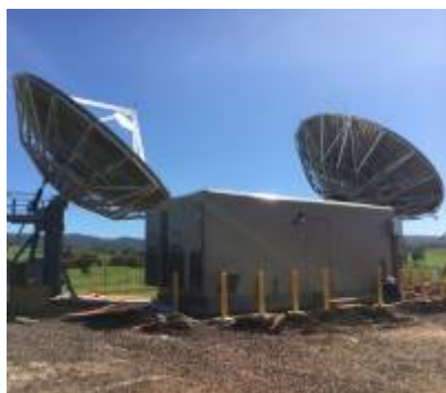
Przykład kontenera z osprzętem satelitarnym
